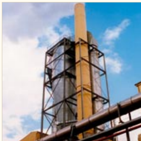
Instalación de Control de Ciclones ABC7
